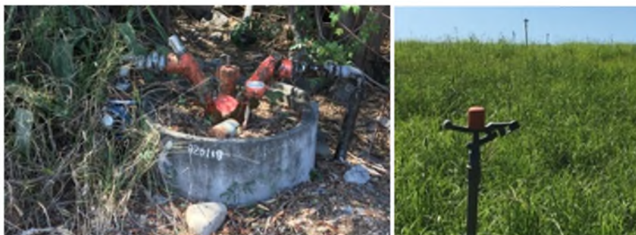
Système d'irrigation présent sur site
